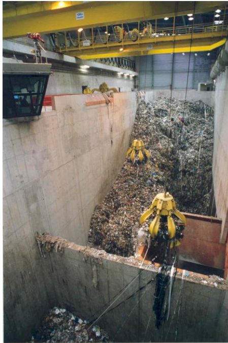
Afbeelding 3. Afvalkraan in de bunker. Bron Twence Afval en Energie.
